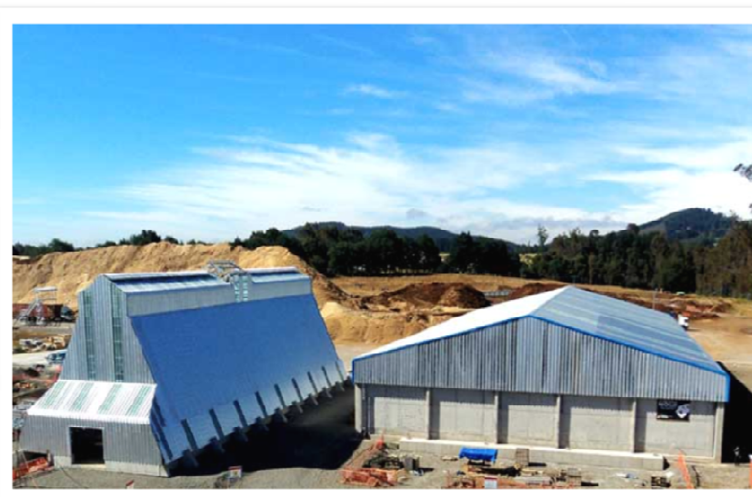
Planta Recuperadora de Energía Lautaro (2011)
